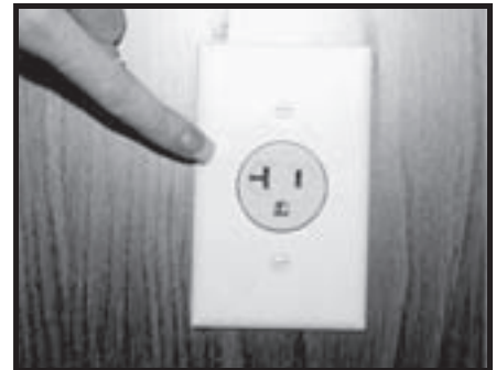
NEMA 5-20 20 amp Receptacle
